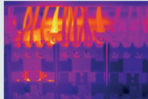
Installaties in stand houden: te hoge temperaturen bij zekeringen en elektrische componenten detecteren voordat deze uitvallen.
